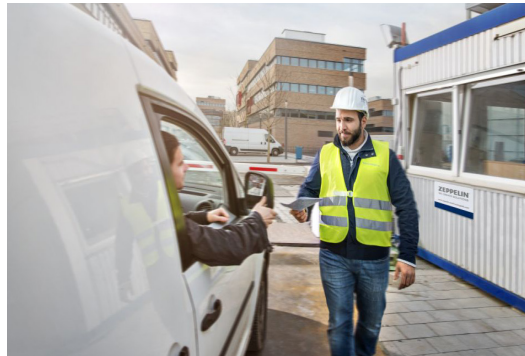
Mit Hilfe des Online-Avisierungs-Systems koordinierten die Baulogistiker vor Ort alle Transporte auf die Baustelle.
