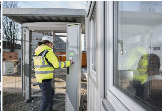
Nur berechtigte Personen können mit ihrem Baustellenausweis das Drehkreuz passieren.
